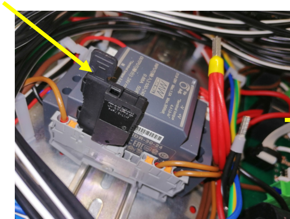
Afb.: Grondplaat NR 8012, zekeringshouder in klemmenblok op de C-rail (naast hoofdrelais)
